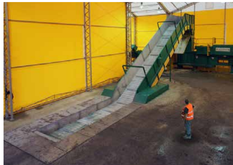
SECTION DE CHARGEMENT EN FOSSE
